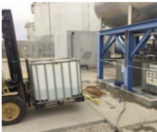
Equipos tradicionales para la descarga de GTGs (1)
